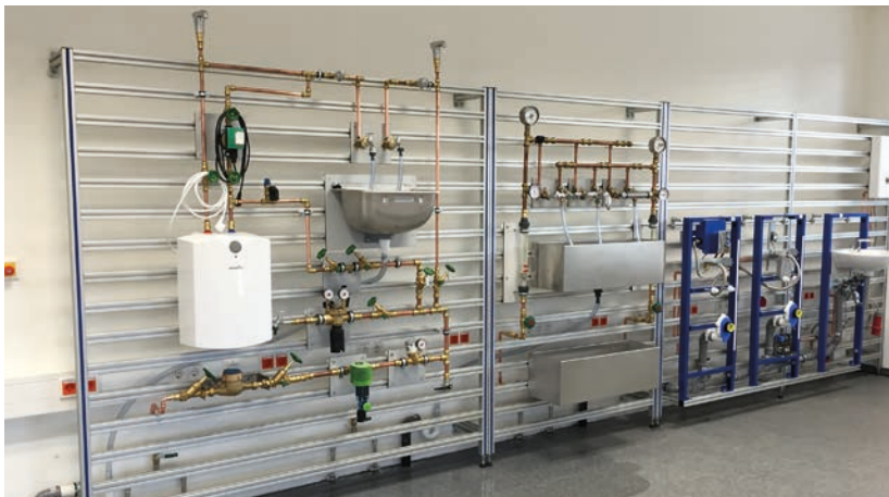
Modulsätze Trinkwasser/Sanitärsteuerungen auf Wandgestell
