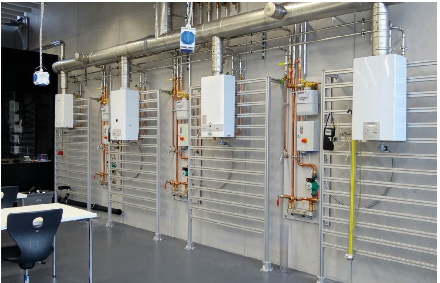
Wandarbeitsplätze mit Energiesäulen
