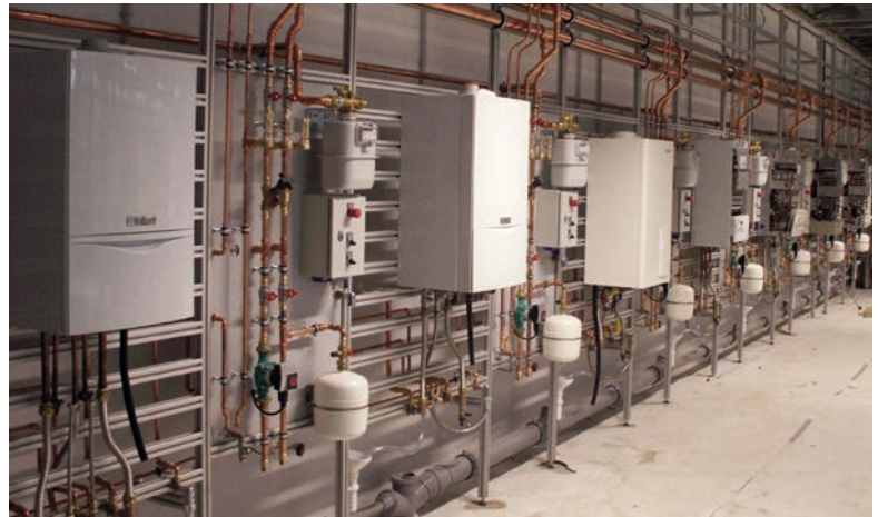
Wandarbeitungsplätze mit Energiesäulen
