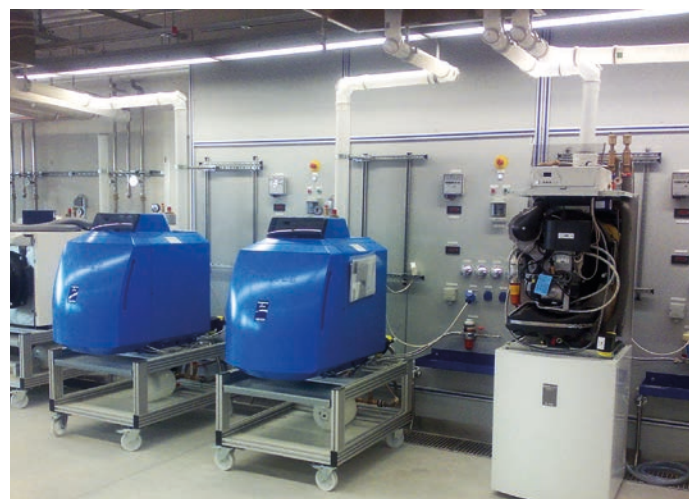
Standkessel an Ölgeräte-Versuchsstände
