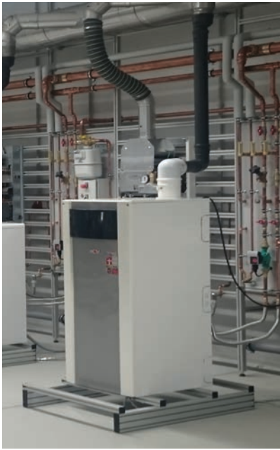
Kesselpodest für Standgeräte
