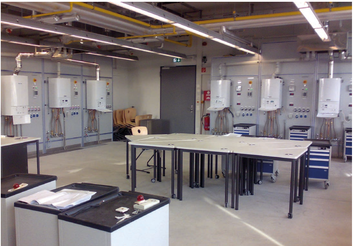
Labor für Gasgeräteschulung
