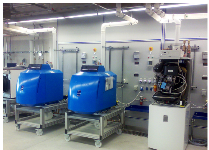
Standkessel an Ölgeräte-Versuchsstände
