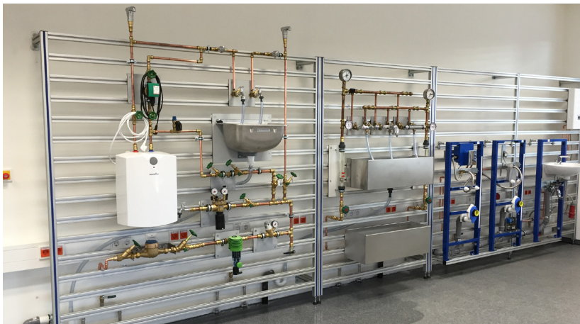
Modulsätze Trinkwasser/Sanitärsteuerungen auf Wandgestell
