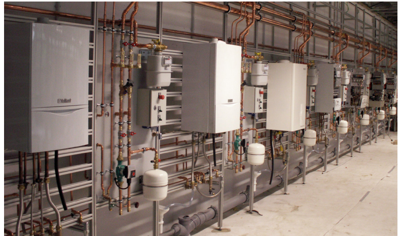
Wandarbeitsplätze mit Energiesäulen
